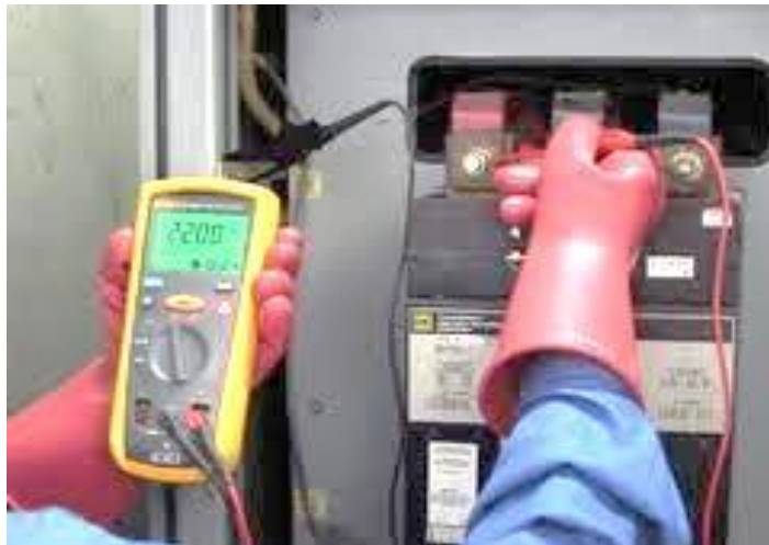
รูปที่ 1 การตรวจสอบอุปกรณ์ไฟฟ้าก่อนใช้งาน
