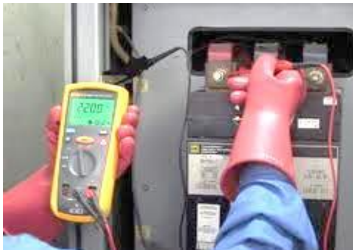
รูปที่ 1 การตรวจสอบอุปกรณ์ไฟฟ้าก่อนใช้งาน
