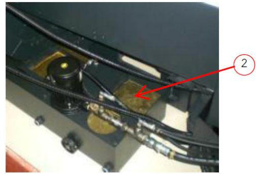
รูปที่ 6.6 จุดตรวจสอบการเติมสารหล่อเย็น
